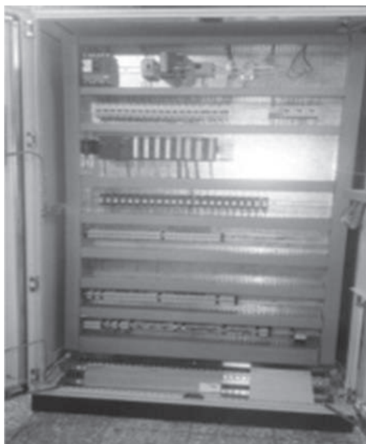
شکل ۱- تابلو برق و کنترل رکتیفایر ED سالن رنگ بن رو
