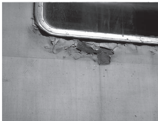
شکل ۴- ترک خوردن عمقی
