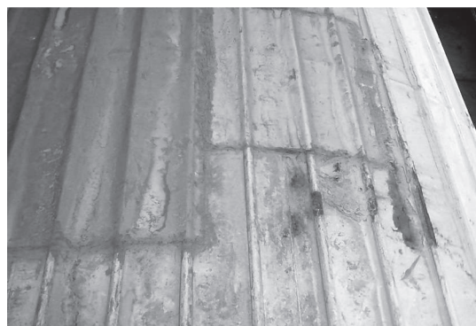
شکل ۵ - ترمیم نادرست پوشیدگی های سقف یک واگن
